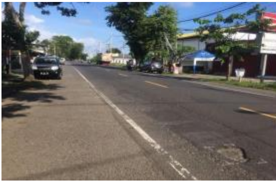
Gambar 3. Kondisi Ruas Jalan
