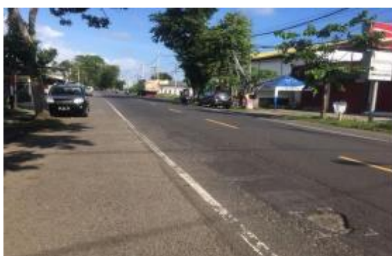
Gambar 3. Kondisi Ruas Jalan
