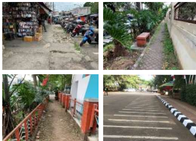
Gambar 1. Kondisi Trotoar Alun-alun Kota Cimahi
