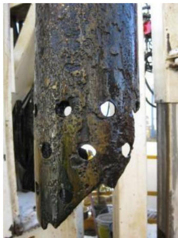
Gambar 10. Korosi berat pada pipa liner di sumur KJ-39 [5].
